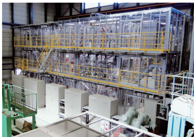
大洗研究所 連続水素製造装置 (ISプロセス)
